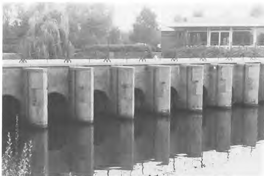
De brug met de twaalf gaten, inundatiesluis voor het gebied ten oosten van Utrecht; wateraanvoer via de Kromme Rijn vanuit Wijk bij Duurstede (foto G. Koppert).
