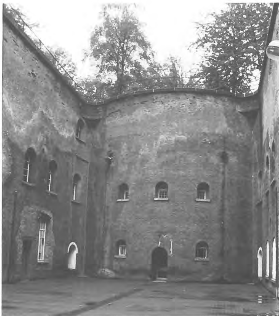
Fort IV. De binnenplaats van het reduit. (foto: P. J. J. van Dijk)
