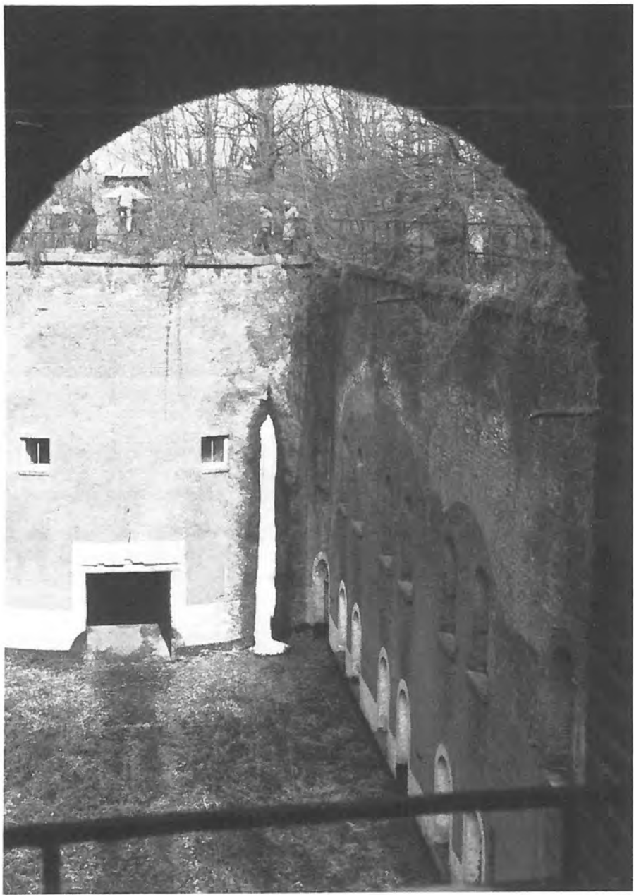
Doorkijk vanuit de gaanderij op de binnencour met de bevroren lekkage. (Foto H. A. Treu)
