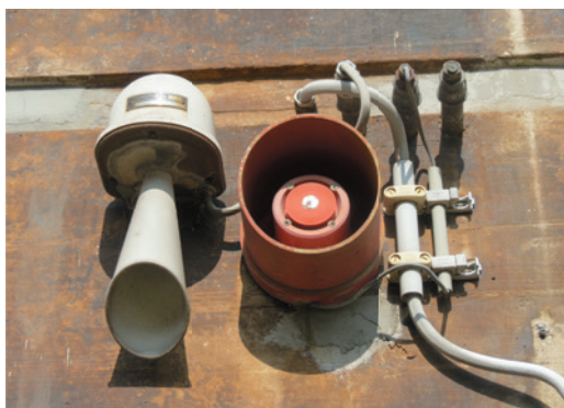
Soesterberg, ex-vliegbasis, sireneapparatuur aan de wand van de Amerikaanse commandobunker (bunker 600). Deze bunker ligt in het Shelterkamp Noord. (foto Dik Winkelman)
