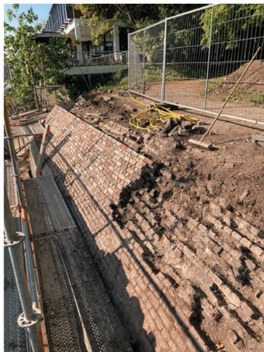
Maastricht, Bij de herstelwerkzaamheden aan de Lunet Sint Pieter kwam ook een deel van de beer voor de saillant van het werk in het zicht. (foto Ron Werné, gemeente Maastricht)
