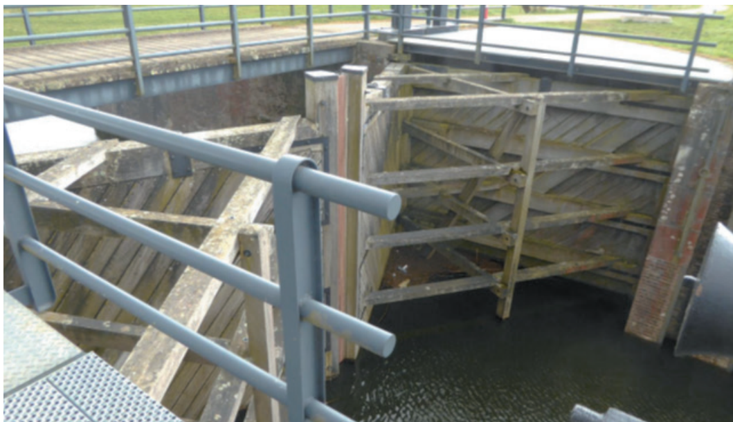
De Papsluis in de oostdijk van de Bakkerskil, ook met (kleine) waaiersluisdeuren, en aan de zuidkant een vispassage (foto Ad Littel)
