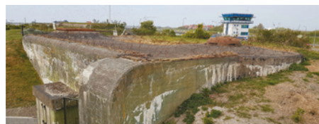
Zoeklicht kazemat VII te Kormwerderzand. Zoals te zien, steekt bij de observatiekoepel de muur uit.
