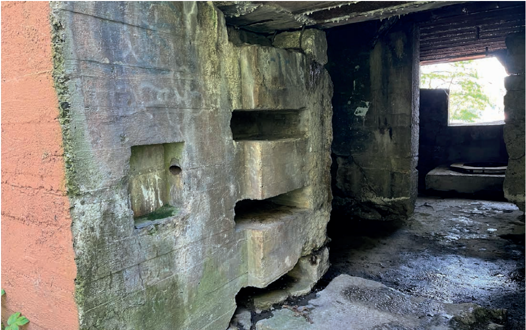
Gerestaureerde Duitse bunker van de Pantherstellung, binnenkant. Deze kant is niet gerestaureerd en laat duidelijk sporen zien van de poging om de bunker op te blazen.
